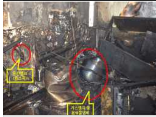
발화지점 가스사용시설 배치 상태
