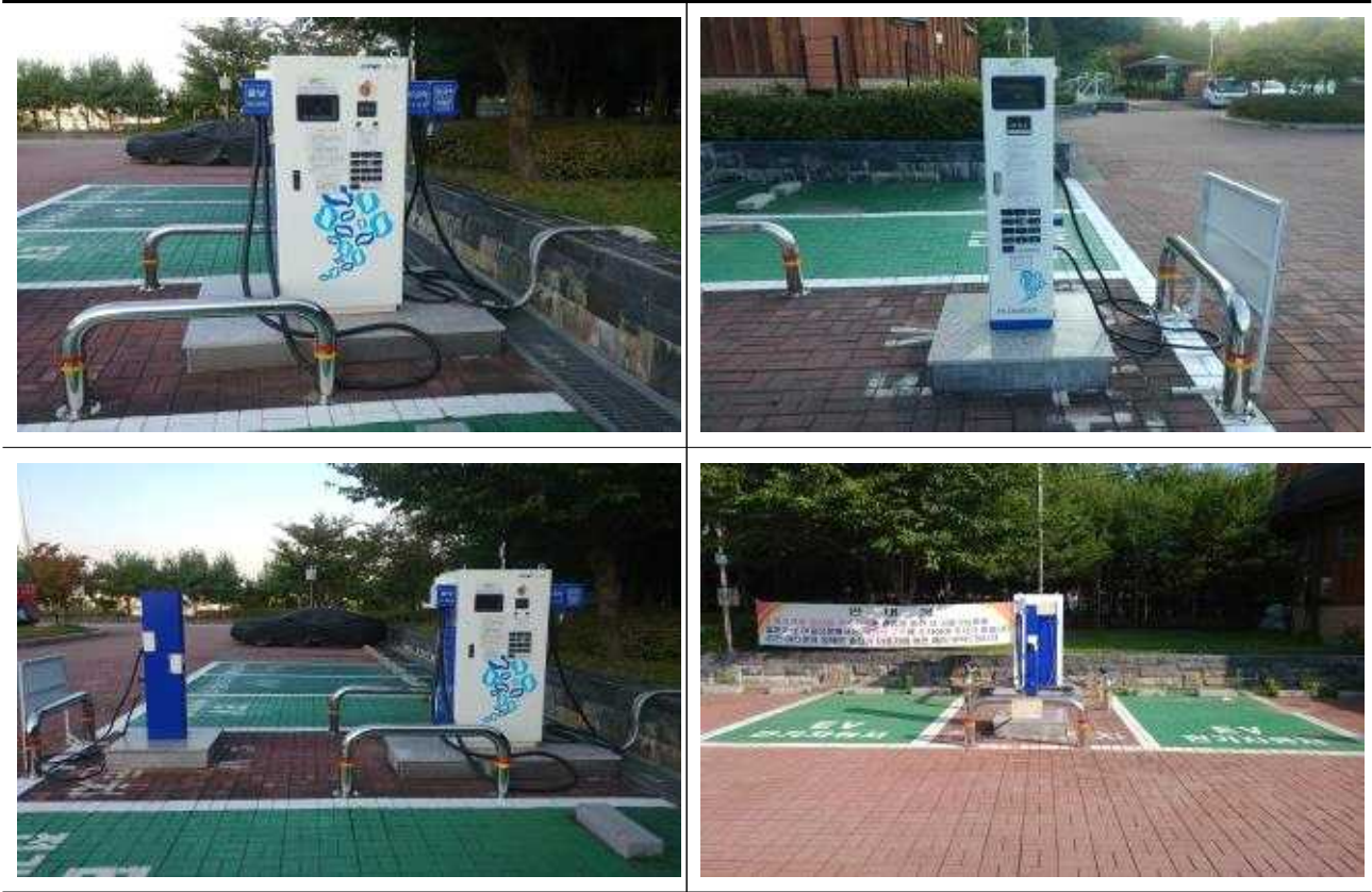
<그림 1> 탄천물재생센터 마루공원 주차장시설 내 충전시설 현황 사진
