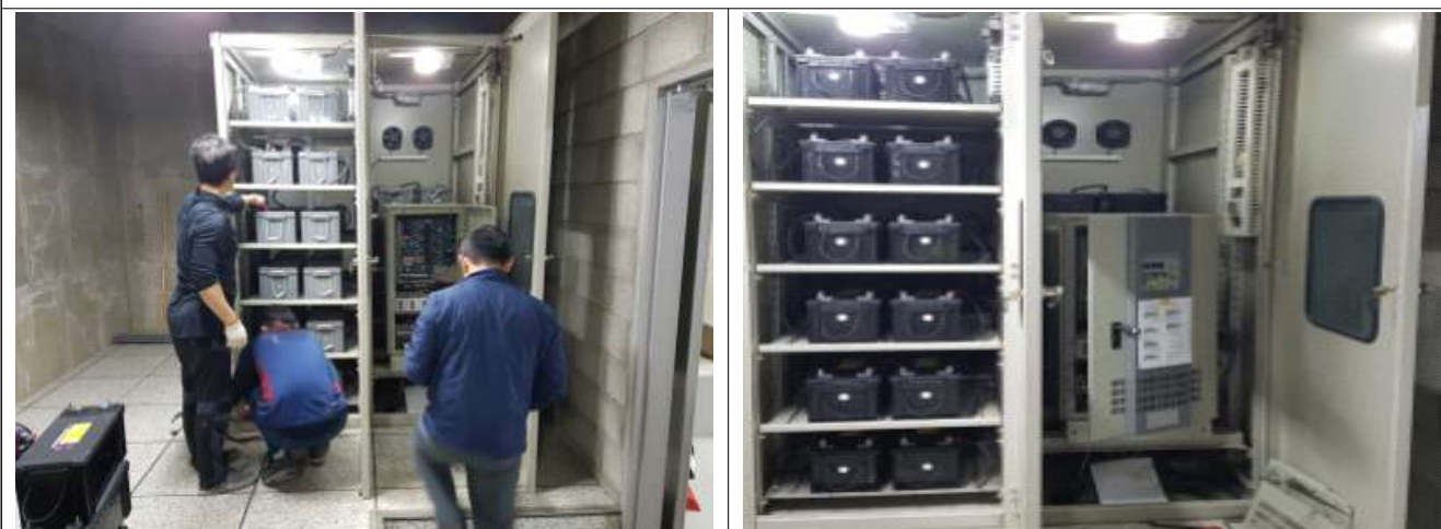
UPS 배터리 교체 사진
