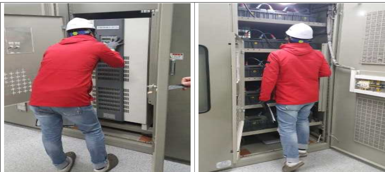
UPS 부하 운전 및 점검 사진
