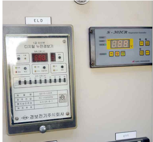
변압기 온도 및 누전 상태 확인
