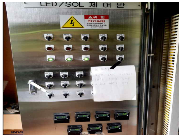
난지물놀이장-LED, 제어반 램프 확인
