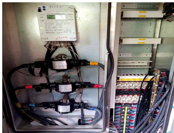
난지물놀이장- 계량기 및 케이블 상태 확인
