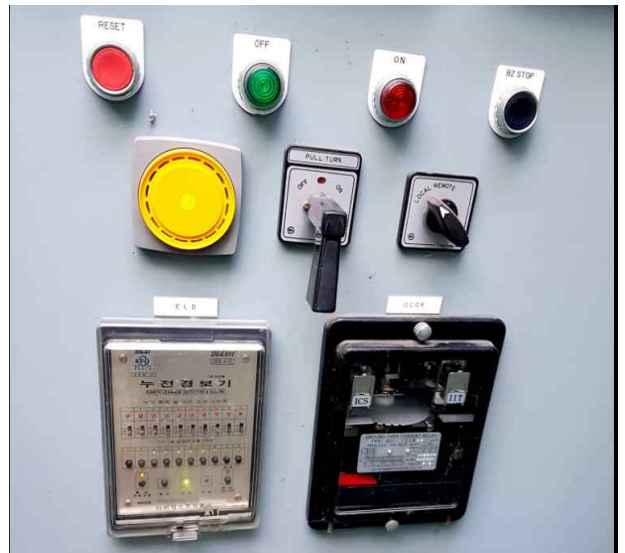
누전경보기 및 OCGR 상태 확인
