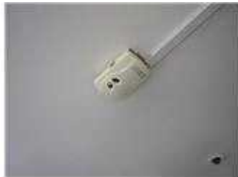
▲ 가스누설경보기의 탐지부가 설치된 사례
