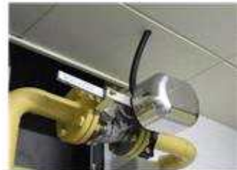
▲ 가스누설경보기의 차단밸브가 설치된 사례
