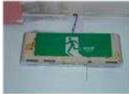
▲ 유도등이 부식되어 점등되지 않는 경우
