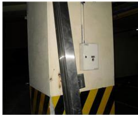
▲ 방화셔터 레일이 파손된 상태로 방치한 경우
