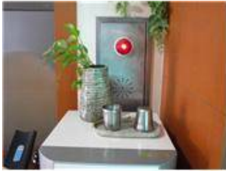
▲ 적재물로 인하여 소방시설의 사용이 제한되는 경우
