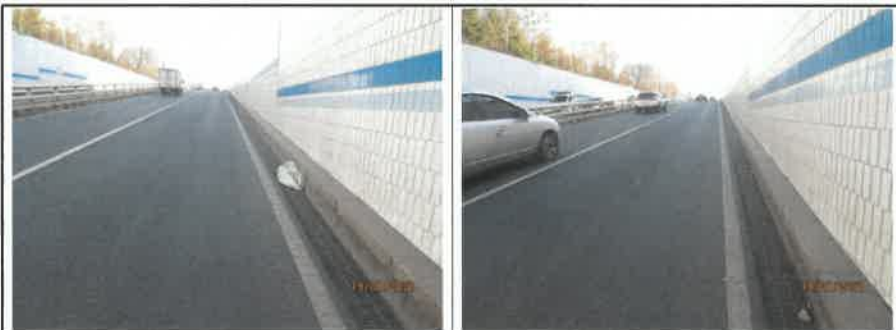
10-2 : 등촌지하차도 배수로 쓰레기 등
