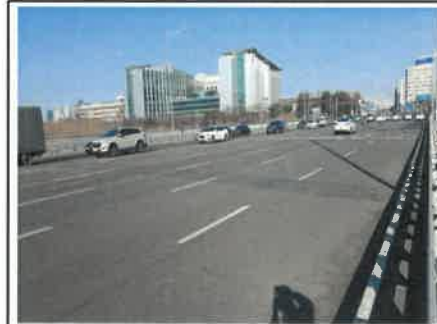
2-1: 여의2교 포장부 현황(포장노후)
