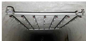
미세 물분사 악취저감시설
