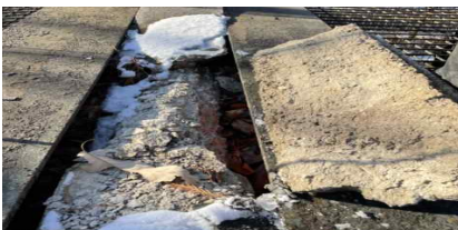
재규어사 지붕 균열
