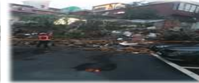
도봉구 공영주차장 담벼락 붕괴(6/30)
