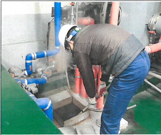
관류보일러 응축수탱크 점검
