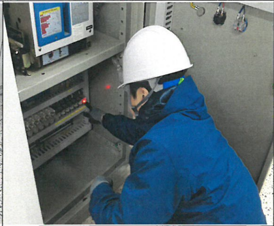
비상발전기 제어반 점검
