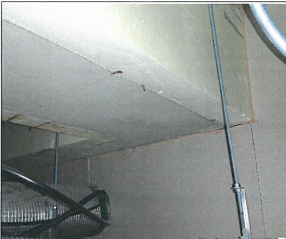
천장 보 변형 및 균열상태 점검
