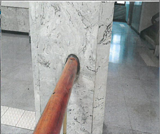
중앙계단 난간대 실리콘 보수
