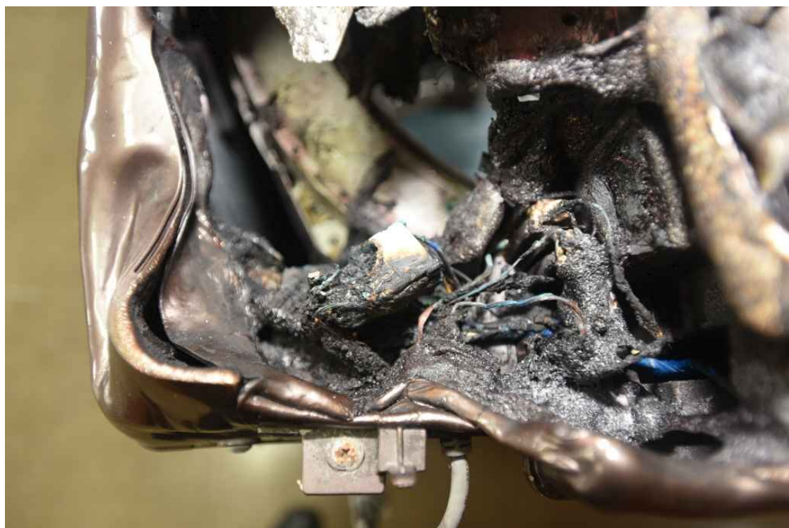
사진 20 모서리 내부 소실 상태 촬영날짜 ○ 커넥터 및 전선 일부가 소실됨 '17. 8. 25.
