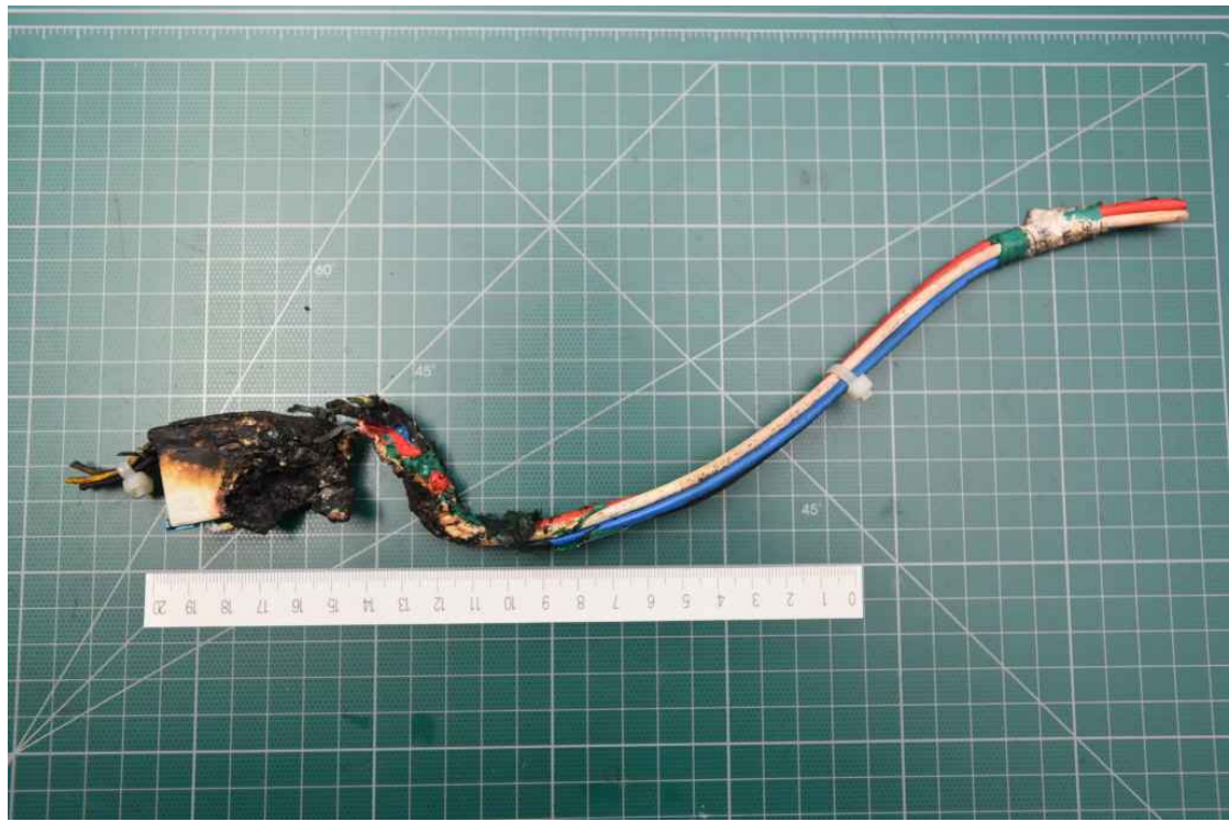
사진 21 커넥터 및 연결된 전선 촬영날짜 '17. 8. 25.
