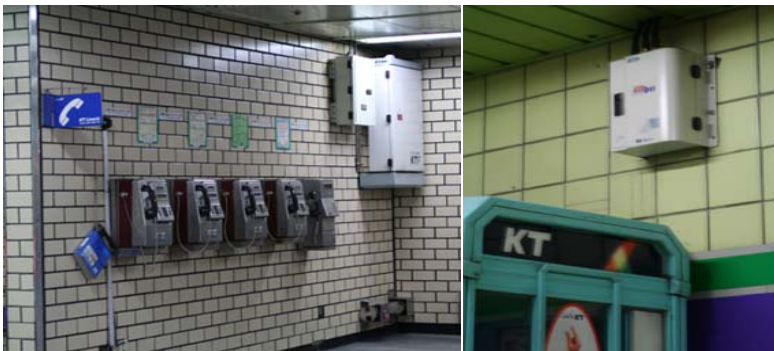
〈그림 4-5〉 지하철 내 설치된 이동통신 중계기
