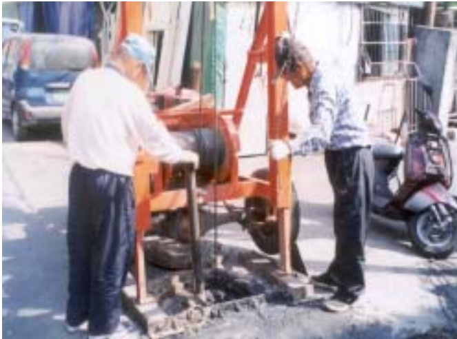
<사진 2.7> 양단의 맨홀사이의 하수관거에 와이어 연결작업 및 하수관거내로 와이어가 연결된 모습(와이어 연결 및 바켓부착②)
