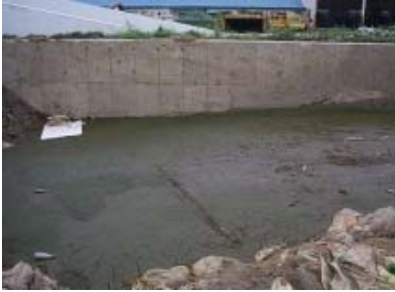
<사진 4.30> 준설토 함수량을 줄이기 위해 설치한 침사지 모습
