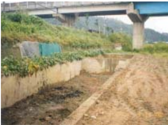
<사진 4.41> 다리밑 하천 변에 설치되어 있는 준설토 침사지 모습
