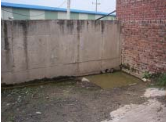
<사진 4.19> 중간적치장의 콘크리트 외벽과 준설토오수가 고여 있는 모습(배수구가 험잡물로 자주 막혀 준설토오수를 흡입기로 처리)
