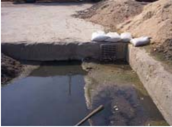
<사진 4.47> 침사지와 준설토오수를 하수관으로 배출하는 배수시설
