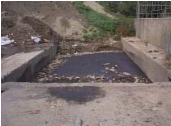
<사진 4.28> 준설토의 함유량을 줄이기 위하여 설치해 놓은 침사지 모습 (침사지의 배수시설이 협잡물에 의하여 막혀 오수를 흡입기로 처리)
