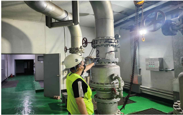
〈신답지하차도 배수펌프 점검〉
