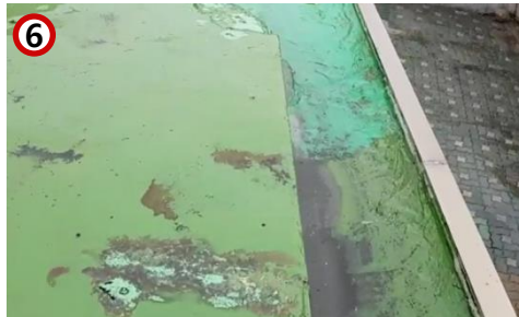
• 노후로 인한 방수 및 칠 벗겨짐-2
