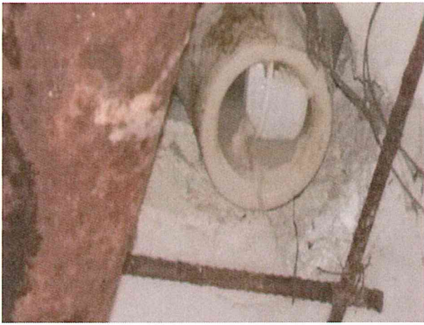
공사 전(막힌 변기)
