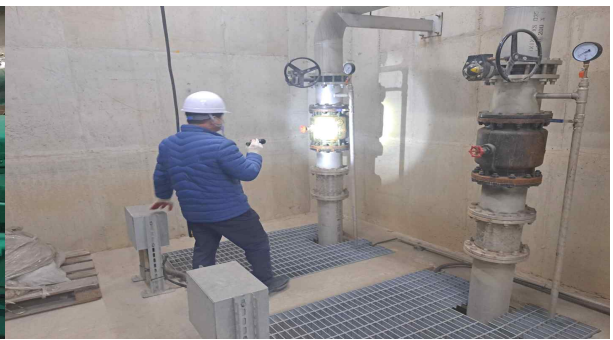
〈위레터널 배수펌프 점검〉
