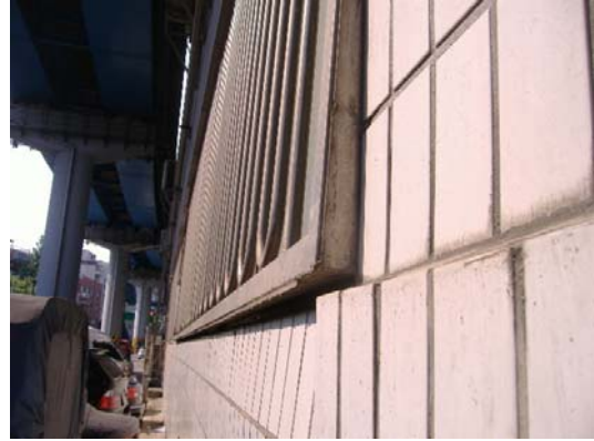
사진6 벽체 전도, 침하 및 창틀이격
