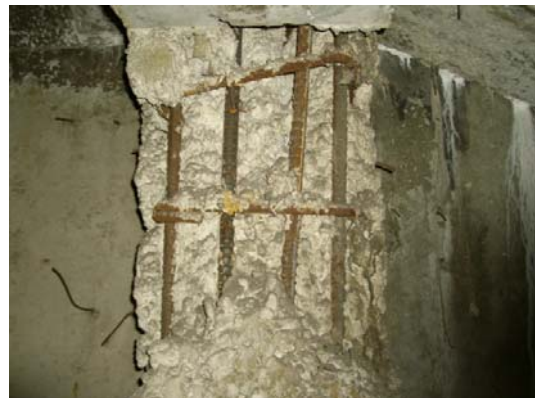
사진10 계단지지 기둥 콘크리트 박락, 철근노출 및 부식
