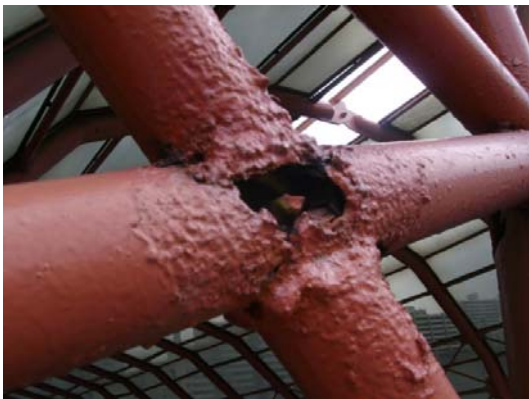
사진23 종점(X27열)부 MP하부 사재 용접부 시공불량, 부재부식
