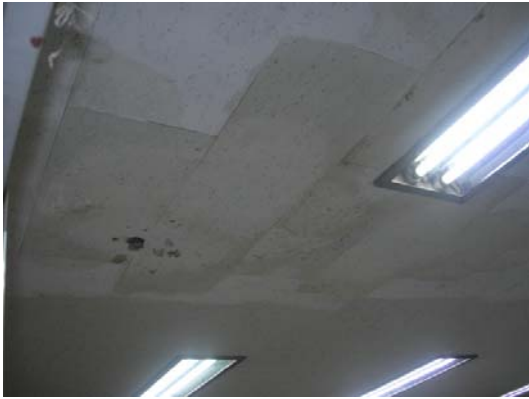
사진1 천장 누수흔적, 오염
