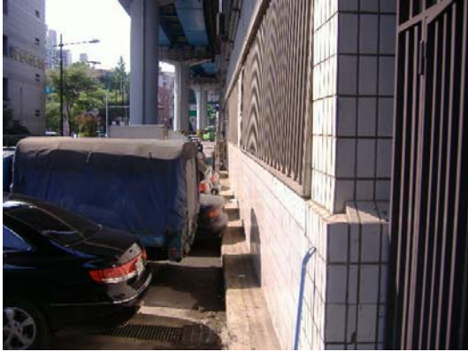
사진5 벽체 전도, 침하 및 창틀이격
