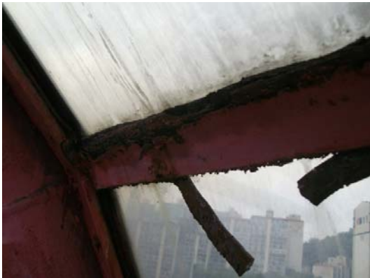
사진29 창 지지 수평철판 부식, 백업재 노후화 및 손상
