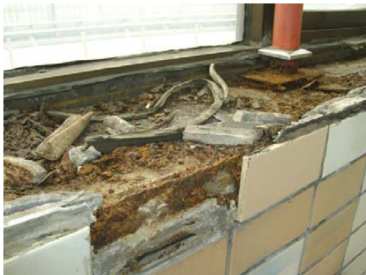
사진13 창틀 하부 철물부식, 타일들뜸 및 탈락
