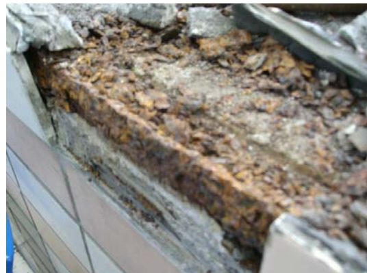
사진14 창틀 하부 철물부식, 타일들뜸 및 탈락
