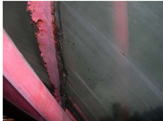
사진30 창 지지 수평철판 부식, 백업재 노후화 및 손상
