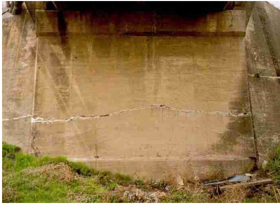
<구체 횡방향 균열>
