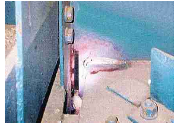
<거세트판 연결 복부판 균열>
