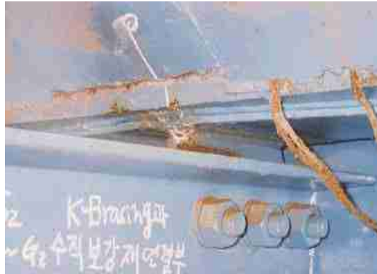
<가로부 연결보강재 균열>
