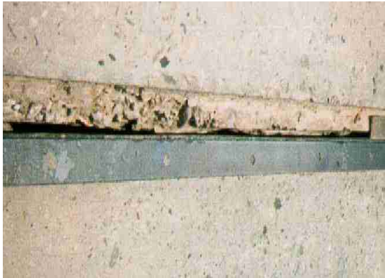
<본체 앵글 파손>
