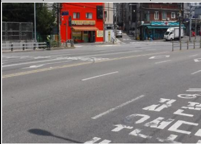
교면포장 - 아스콘 균열/소성변형
