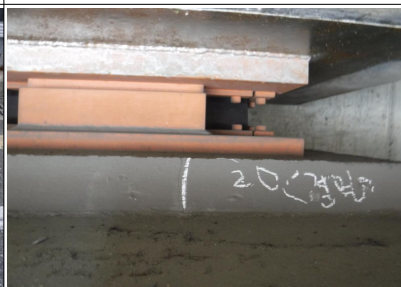
교량받침 - 받침몰탈 균열
