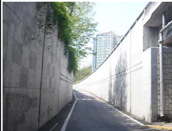
접속옹벽 전경(시점 좌측)
