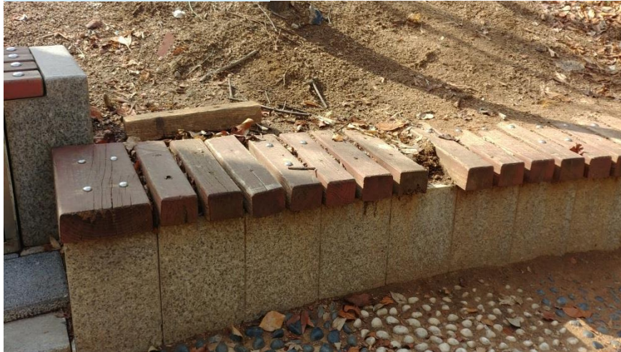
앞음벽 부후 및 파손
