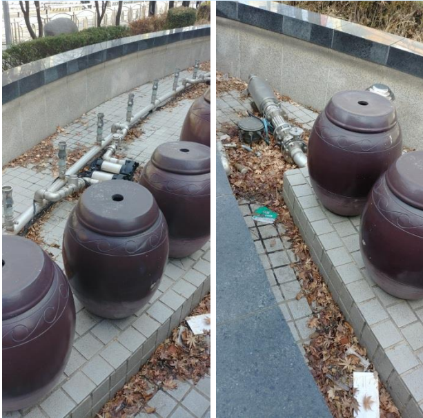
이물질이 펌프에 유입되어 고장을 유발
