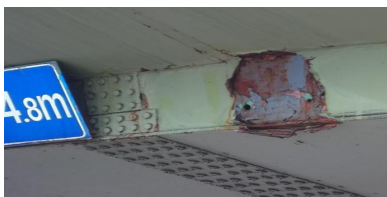
(보도육교 거더 강제 탈락)
