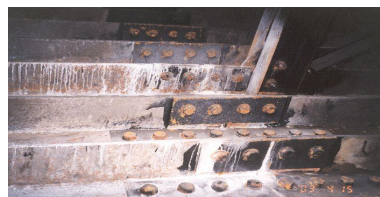
(보도육교 거더내부 볼트 부식)
