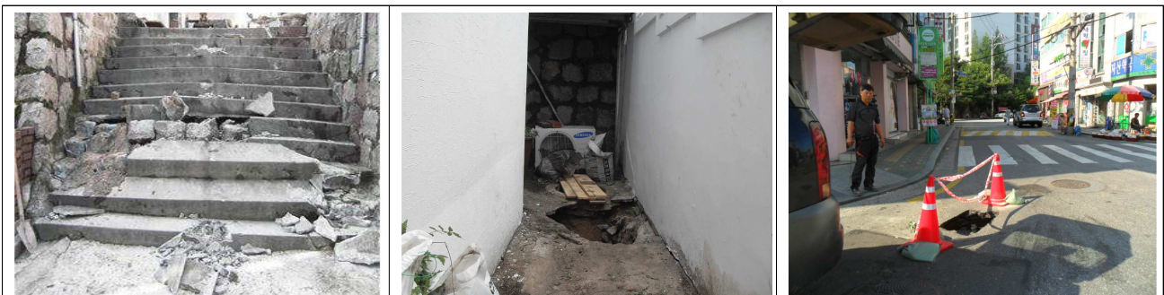
노후하수관 파손에 따른 도로 동공
