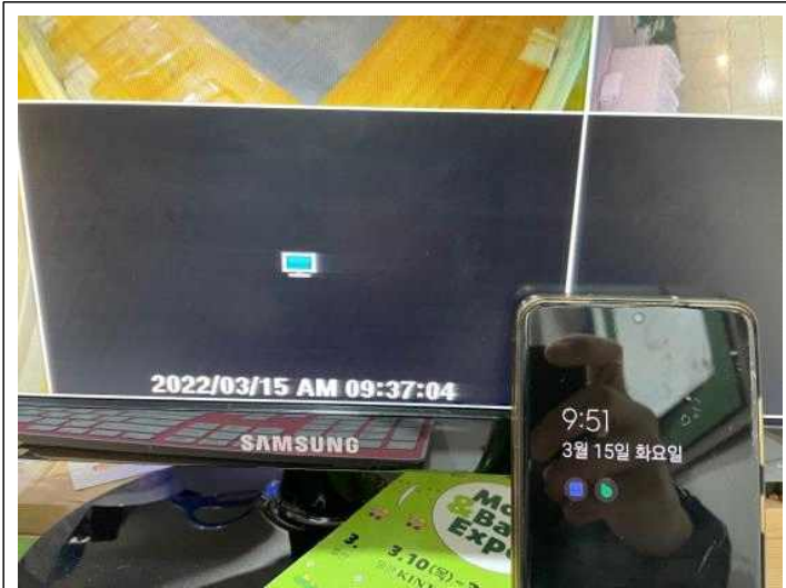
CCTV 시간 실제시간 차이 확인
