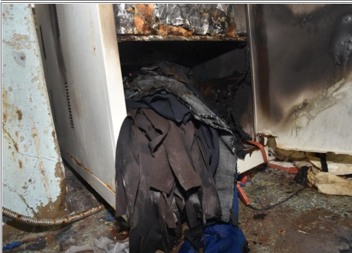
사진 6 스팀 보일러 전면 하부 촬영날짜 ○ 보일러 하부 내부에 섬유류가 다량 쌓여 연소된 모습 2019.05.07.
