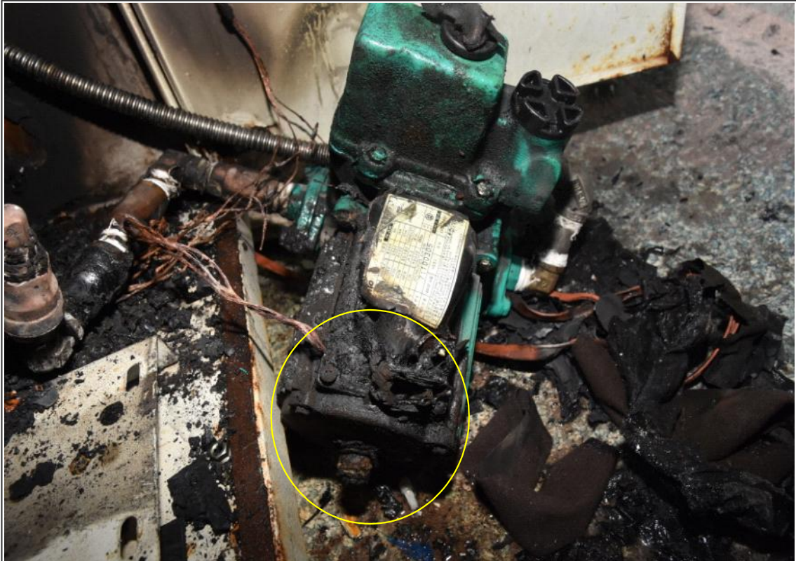
사진 17 급수펌프 후면 촬영날짜 ○ 전체적으로 연소되어 검게 탄화된 모습 2019.05.07.
