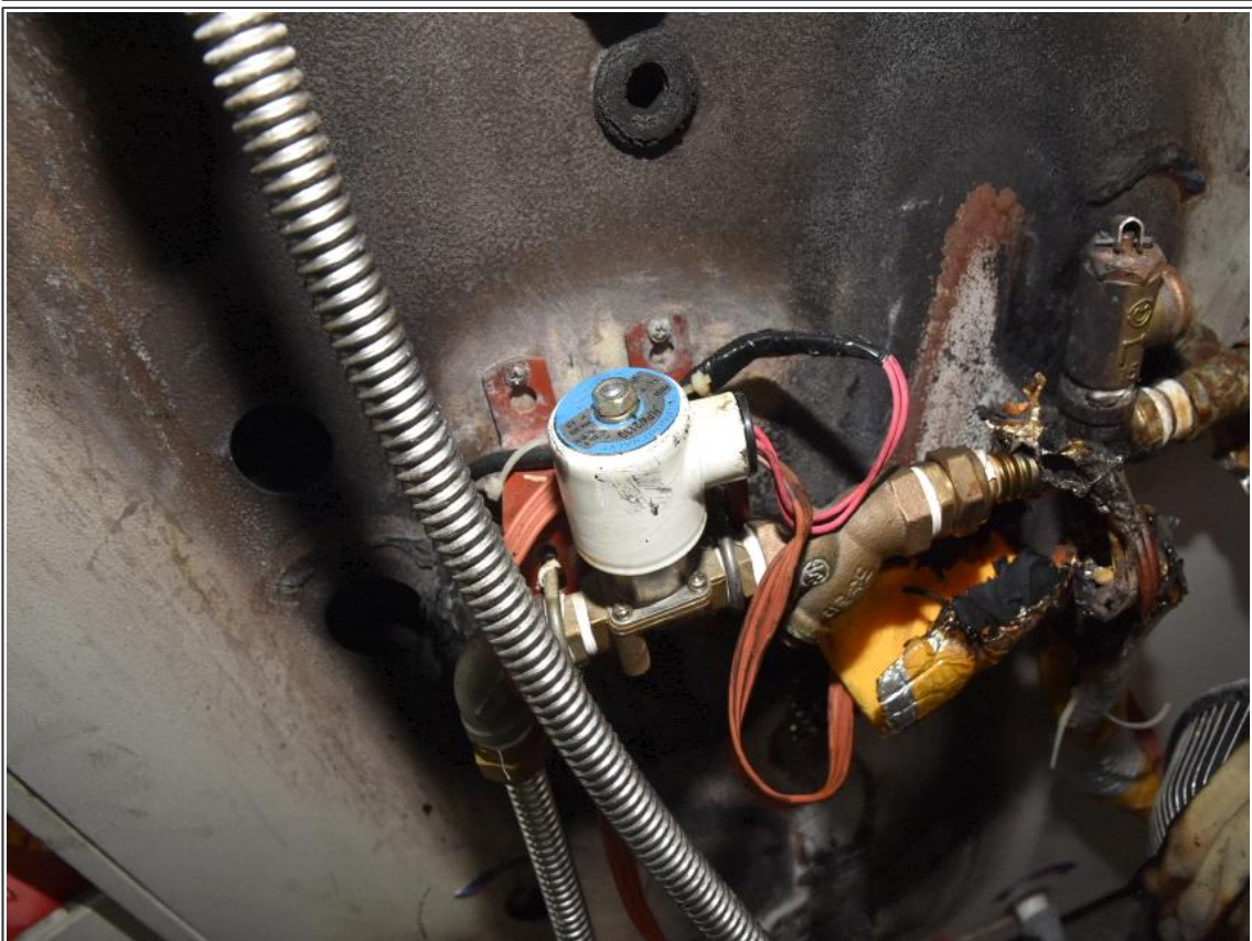
사진 8 보일러 우측 배관 주변 연소상황 촬영날짜 ○ 외부 화염에 의해 일부 연소된 모습 2019.05.07.
