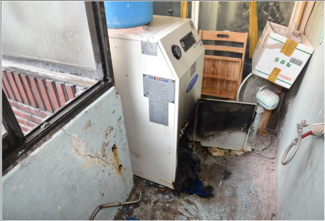
사진 3 발코니 끝 부분에 설치된 스팀 보일러 촬영날짜 ○ 보일러 하부 주변이 연소된 모습 2019.05.07.
