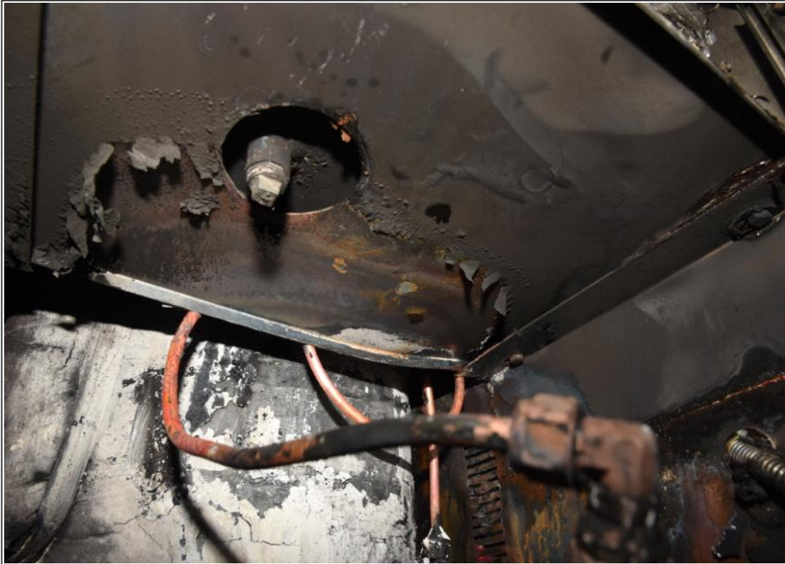
사진 21 보일러 내부 천장 부분 촬영날짜 ○ 끝 부분이 연소되어 변색된 모습 2019.05.07.
