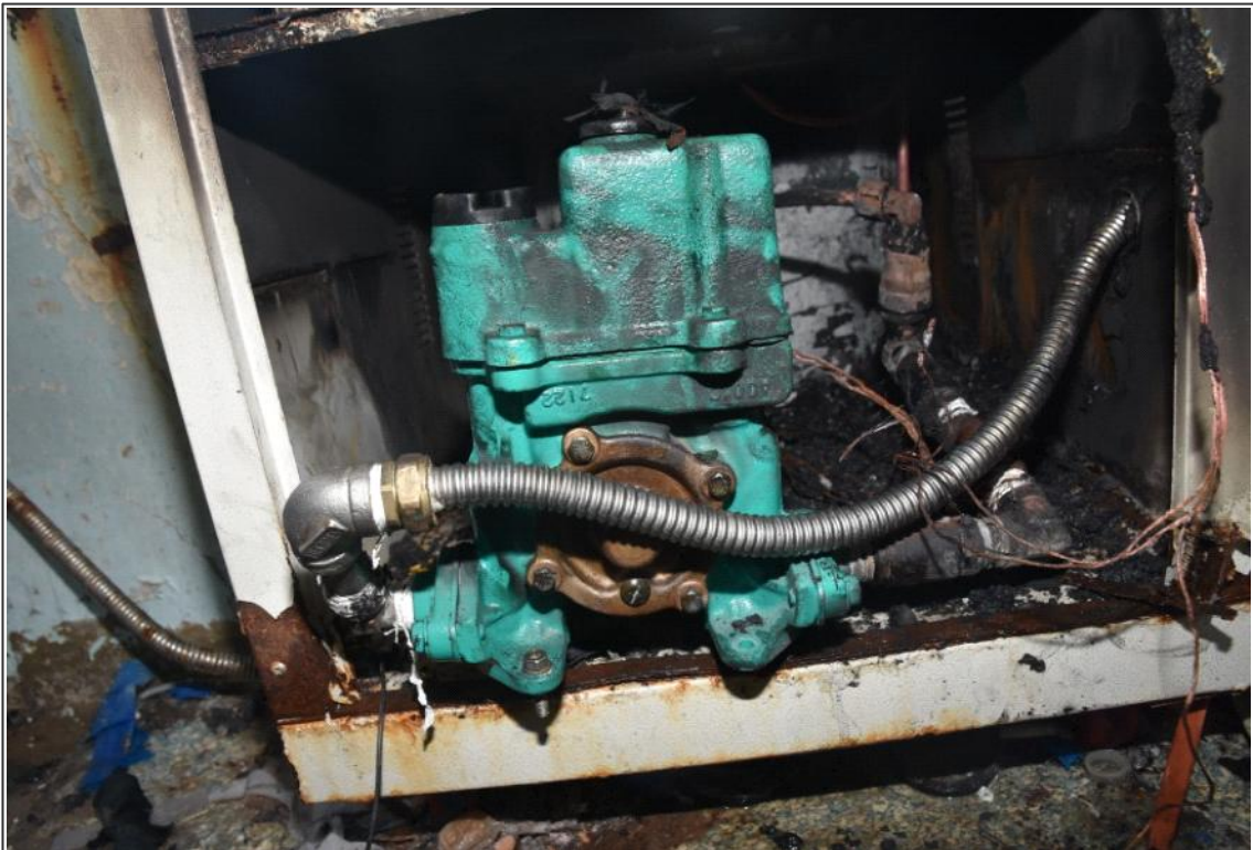
사진 12 보일러 내부(섬유류를 제거한 모습) 촬영날짜 ○ 스팀다리미용 급수펌프가 설치되어 있으며 외부는 특이점 없음 2019.05.07.
