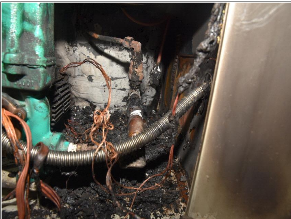
사진 20 보일러 내부 우측 연소상황 촬영날짜 ○ 우측면 모터와 전기배선이 전체적으로 연소된 모습 2019.05.07.
