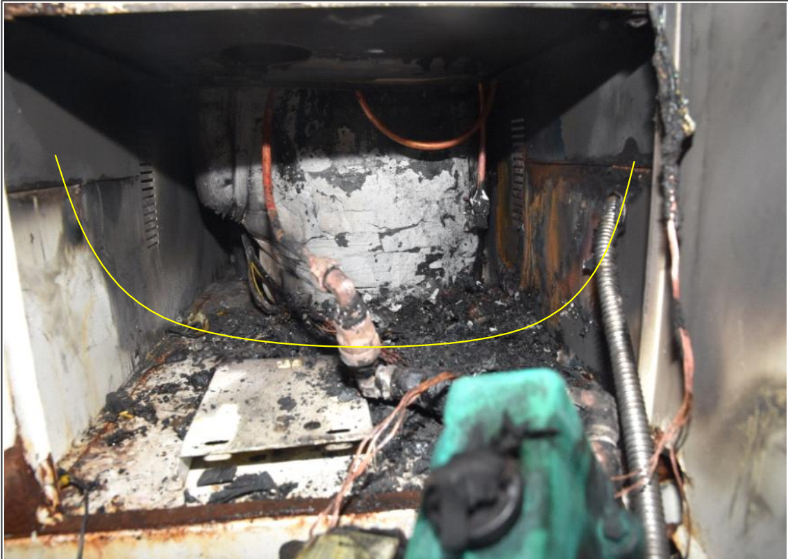
사진 18 보일러 내부(급수펌프 제거후) 촬영날짜 ○ 전면은 특이점이 없고 후면 부분이 전체적으로 연소된 모습이며 우측바닥에 섬유류의 연소 및 용융 잔해물이 적치된 모습 2019.05.07.
