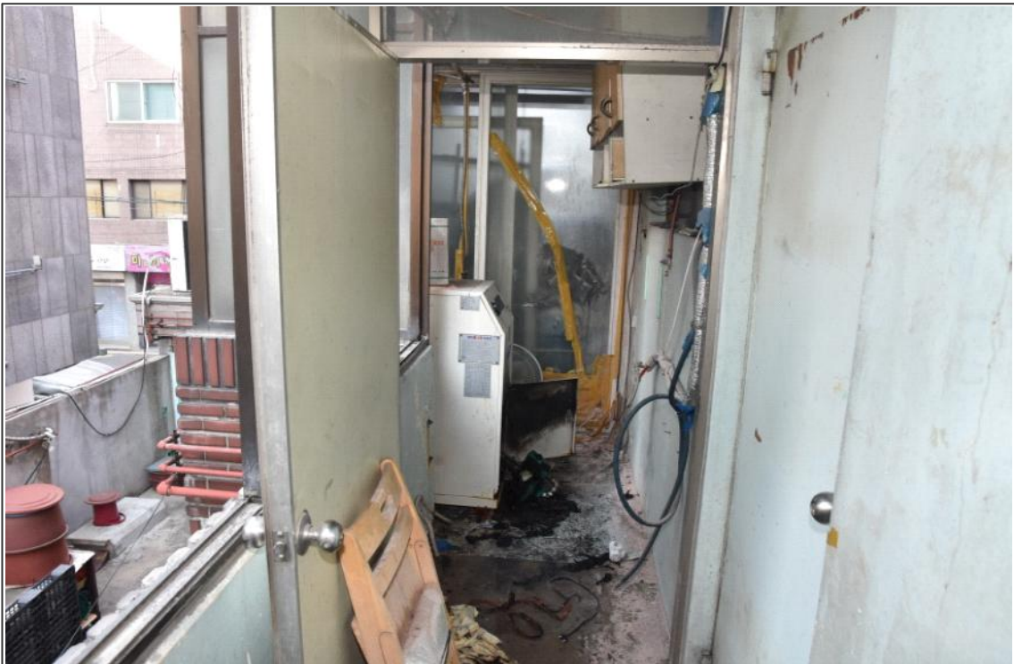
사진 2 2층 의류 가공작업장 후면 발코니 촬영날짜 ○ 발코니 끝 부분 벽면 및 천장 일부가 그을린 모습 2019.05.07.
