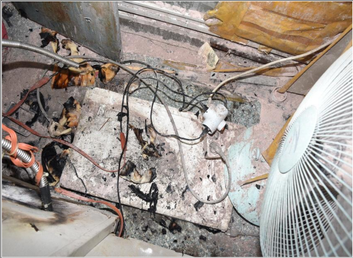
사진 11 보일러 우측 바닥 콘센트 촬영날짜 ○ 3구 멀티콘센트에 3구 T형 콘센트와 전기배선 1개소가 접속되어 있으며 연소특이점은 식별되지 않음 2019.05.07.
