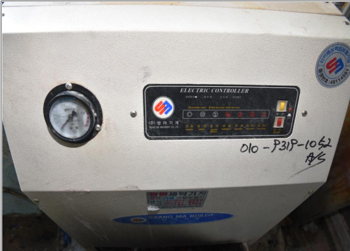
사진 5 스팀 보일러 전면 상부 촬영날짜 ○ 특이점 없음 2019.05.07.
