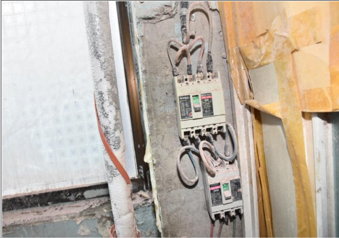
사진 9 보일러 우측 벽면 차단기 촬영날짜 ○ 차단기 2개소 전원이 관계자에 의해 차단된 모습 2019.05.07.
