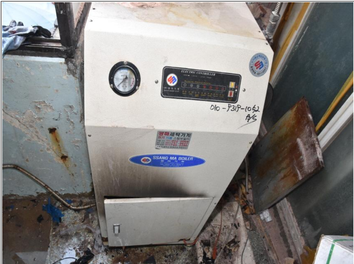
사진 4 스팀 보일러 전면 외함 촬영날짜 ○ 특이점이 없음 2019.05.07.
