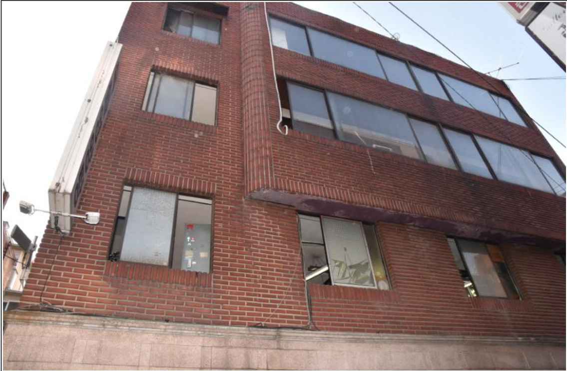
사진 1 화재건물 전경 촬영날짜 2019.05.07.
