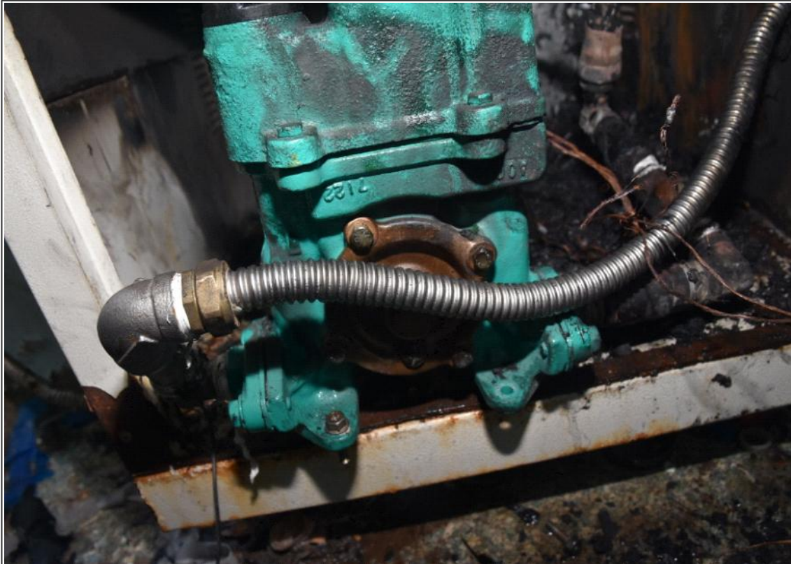
사진 13 급수펌프 전면 촬영날짜 ○ 연소 특이점 식별되지 않음 2019.05.07.
