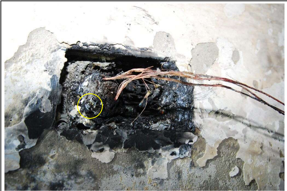
사진 5 벽면 콘센트에 연결된 청소기 코드선 (좌측 90도 회전) 촬영날짜 ○ 사진에 표시한 ○ 부분에서 전기적 용융흔이 발견됨 '11. 10. 26.
