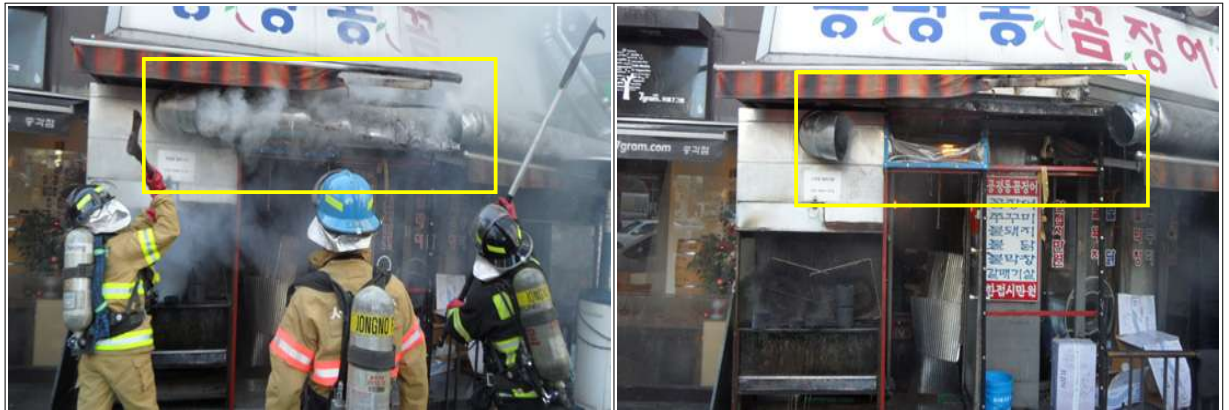
환기덕트의 연소 및 파괴상황 파괴 후 상황
