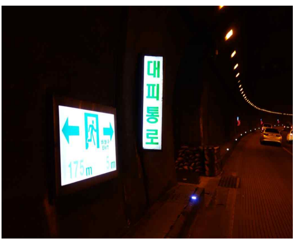
터널 내 피난유도등
