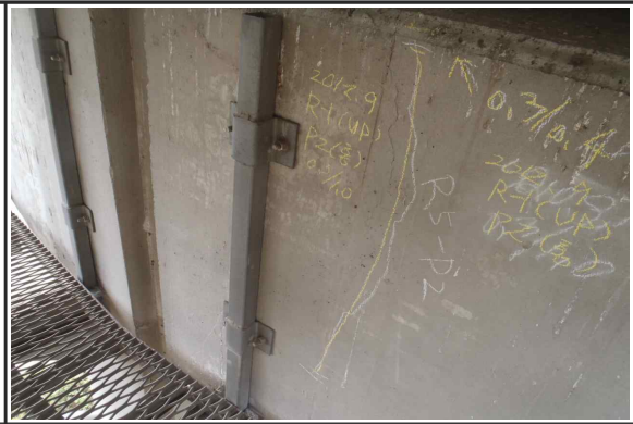
균열(cw ≥ 0.3mm) (램프1(진입), P2, 코핑부)
