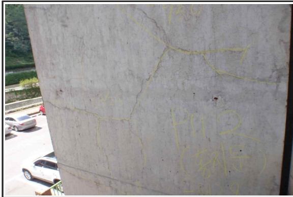
균열(cw ≥ 0.3mm) (본선, P112, 기둥)
