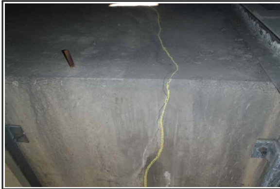
균열(cw ≥ 0.3mm) (본선, A1 구체)
