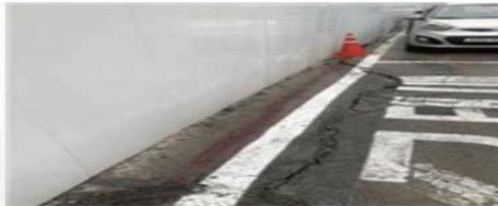
[도로 침하 및 균열 발생]
