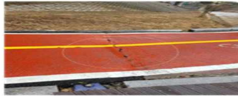
[자전거도로 균열 발생]
