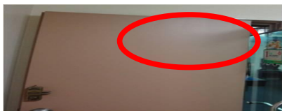
도어체크 탈락 (미설치)
