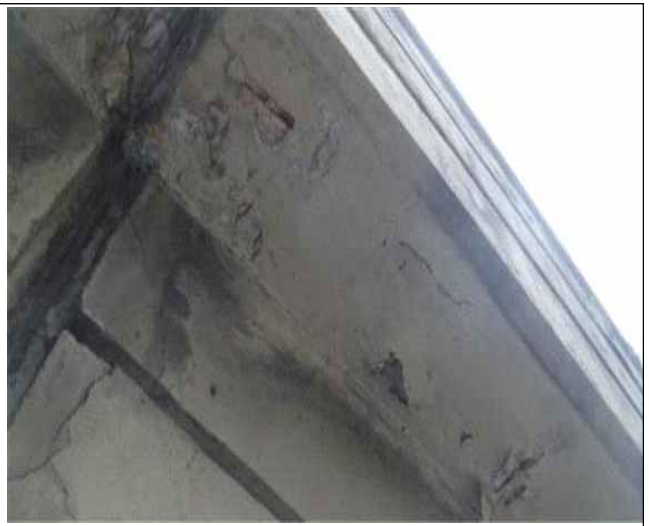
옹벽 철근 노출
