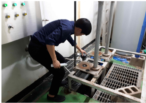
배수설비 동작상태 점검
