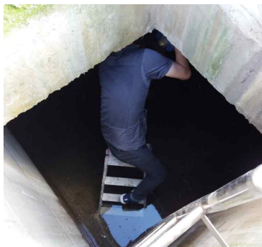
배수설비 동작상태 점검
