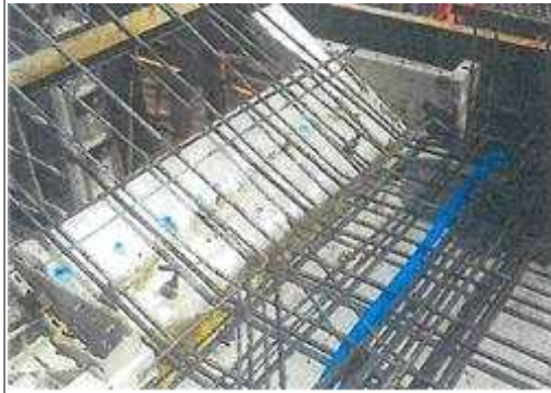
계단절곡부의 상단철근 배근방법 부적합
