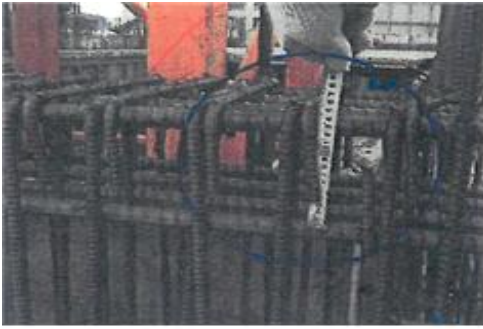
보 상부 주철근의 상단과 하단철근 순간격 부적합
