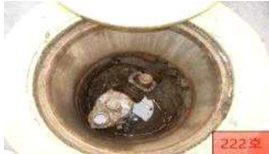
소화전 몸체 및 제수변 교체여부를 확인 할 수 있게 근접사진 촬영
