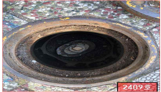
노후 소화전 밸브 교체여부를 알 수 있게 근접사진 촬영
