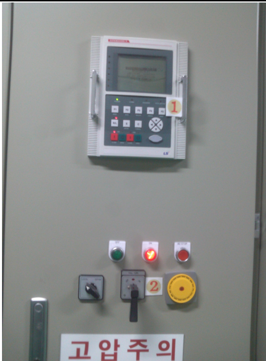
VCB 판넬 리셋동작판넬 (한전복전시 수동조작)
