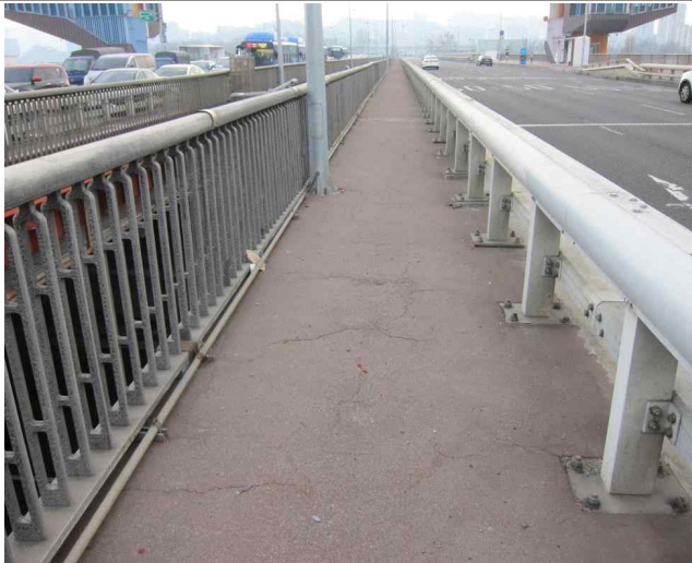
보도 균열 현황
