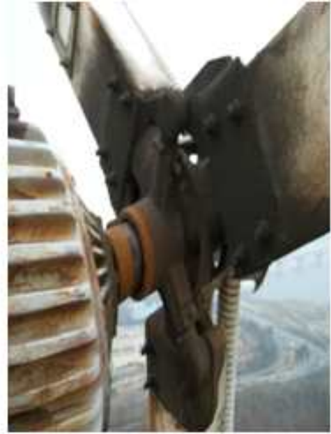
기어유 유출로 인한 오일 오염 상태
