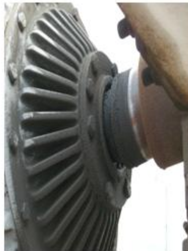
기어유 유출로 인한 오일 오염 상태
