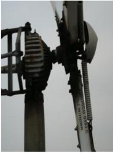
기어유 유출로 인한 오일 오염 상태
