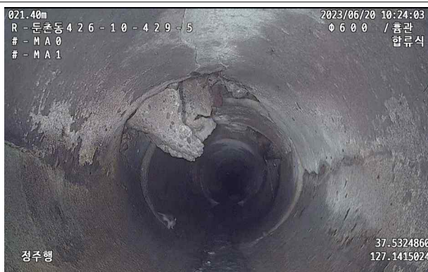
관로 상단부 파손
