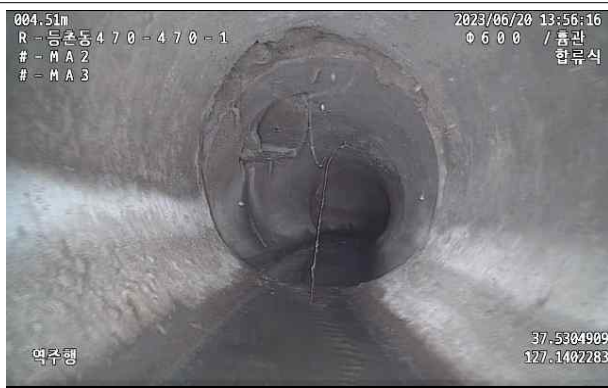
이음부 단차 및 파손
