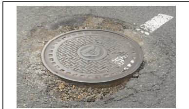
다짐 등 시공 불량
