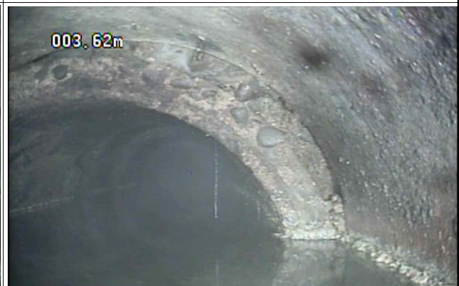
이음부 파손 및 단차
