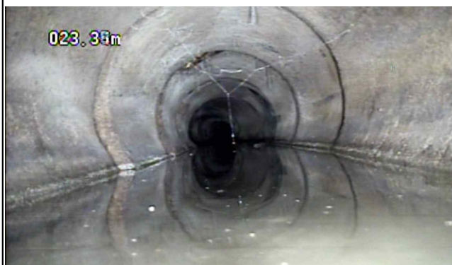
이음부 단차 및 파손
