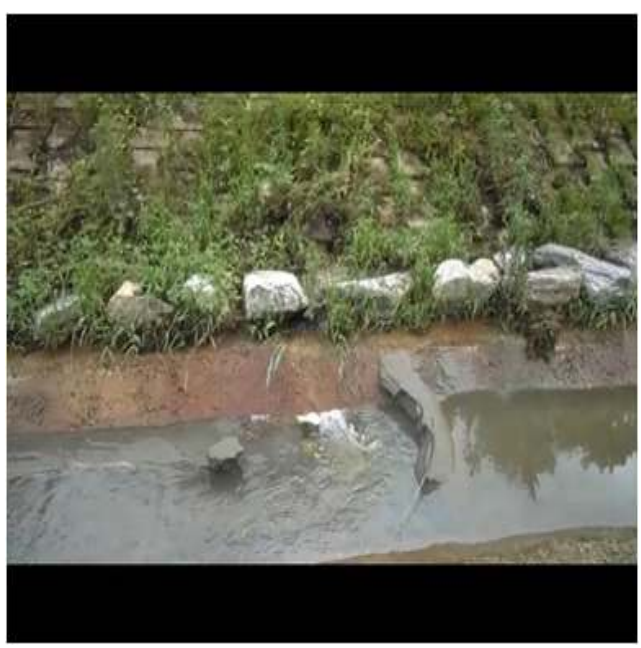
제체 용출수 발생 전경
