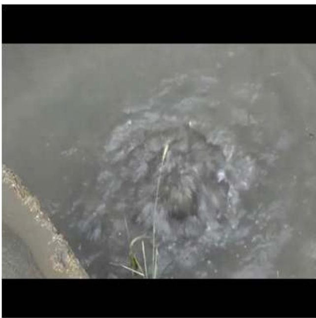
제체 용출수 발생 전경
