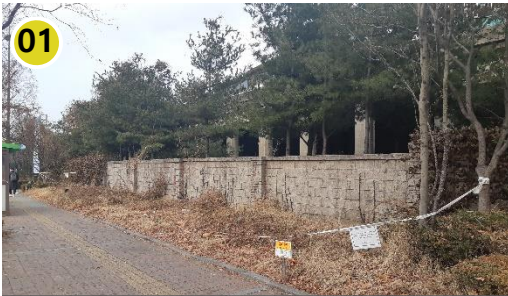
사유지 경계부 헨스 설치 필요함
