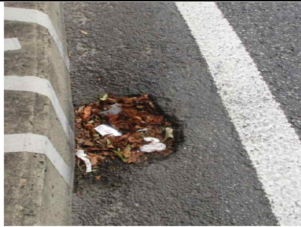
10. 뚝섬고가차도 배수로 퇴적물
