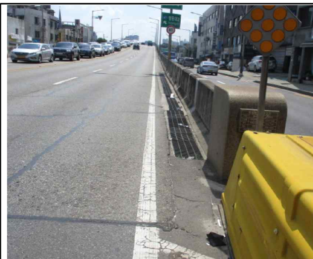
9. 영동대교북단고가차도 배수로 퇴적물
