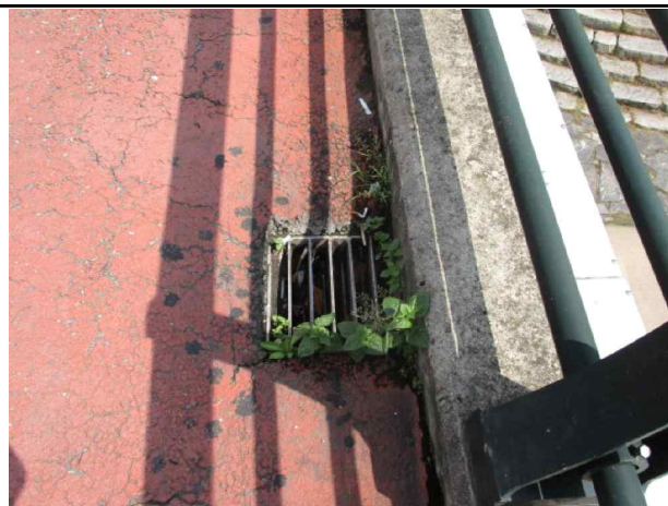
3. 고산자교 빗물받이 퇴적물
