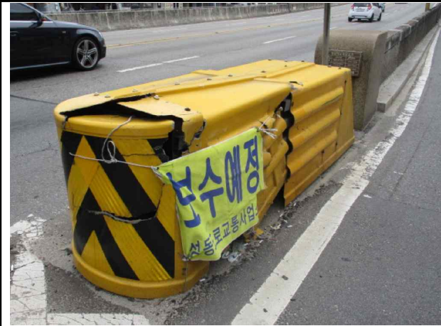
7. 영동대교북단고가차도 충격흡수시설 손괴
