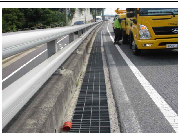
12. 금호고가차도 배수로 퇴적물
