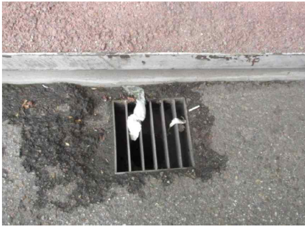
4. 정릉천교 빗물받이 퇴적물
