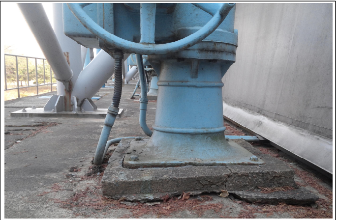
⑤ 제3처리장 수문 권양기 기초 및 앙카 파손
