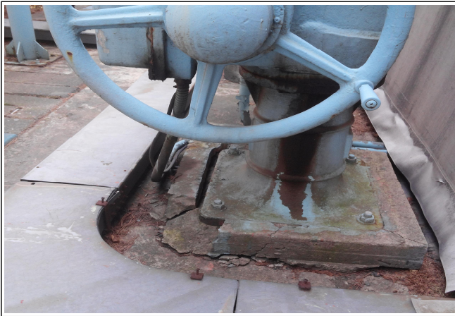
⑤ 3처리장 유입펌프장 수문권양기 받침파손
