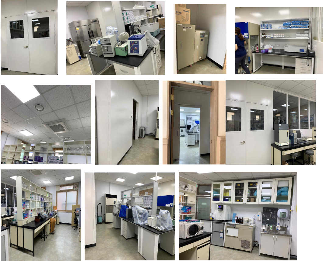
체세포 전용실험실, 체세포 실험을 위한 전용 실험기구 설치, 유전자 실험실, 실험실 증문제작, 천장형에어컨 신설
