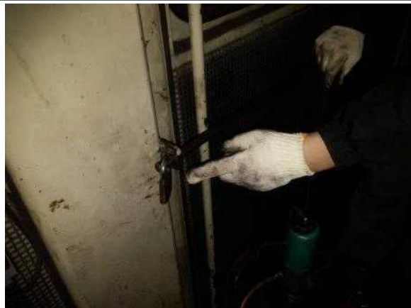
측면 점검문 쇠정상태 점검
