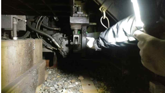
유압라인 누유 점검
