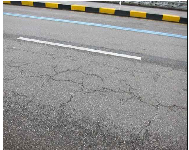
교면 균열 현황
