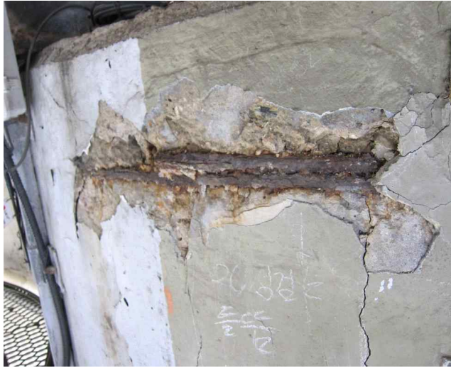
교각 손상 현황
