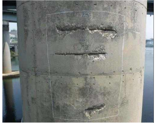
교각 손상 현황
