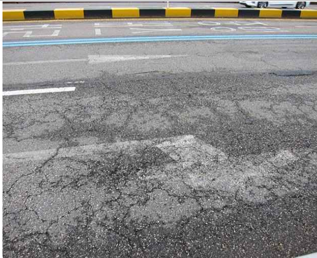
교면 균열 현황
