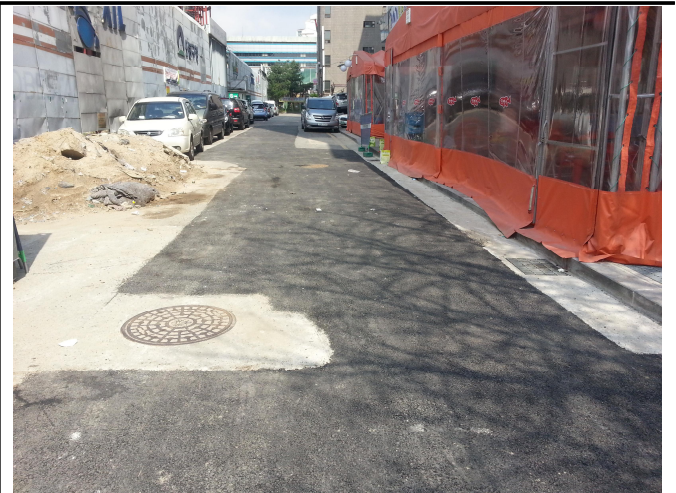
기존 하수맨홀(창동 지하차도 배수관과 연결됨)
